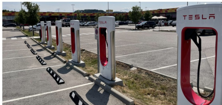
Im Frunpark Asten wurde die bestehende Infrastruktur für Elektroautos und E-Bikes um zwölf Schnellladestationen erweitert.
