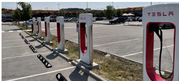
Im Frunpark Asten wurde die bestehende Infrastruktur für Elektroautos und E-Bikes um zwölf Schnellladestationen erweitert.
